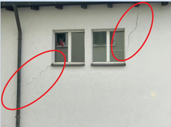
Pfarrsaal WC Anlage: Risse im WC Wände und Decke
