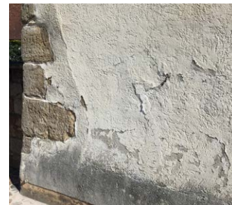
Fassade: Verputz stark beansprucht, teilweise beschädigt
