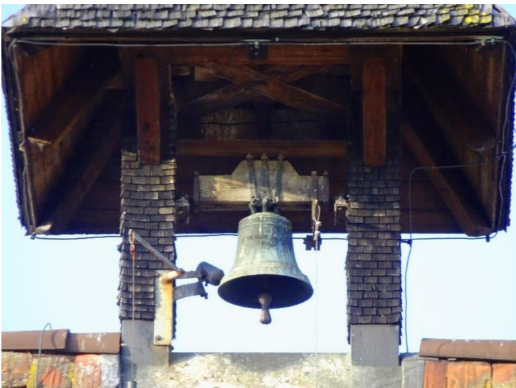
Dachreiterturm mit stark beschädigtem Schindeldach
