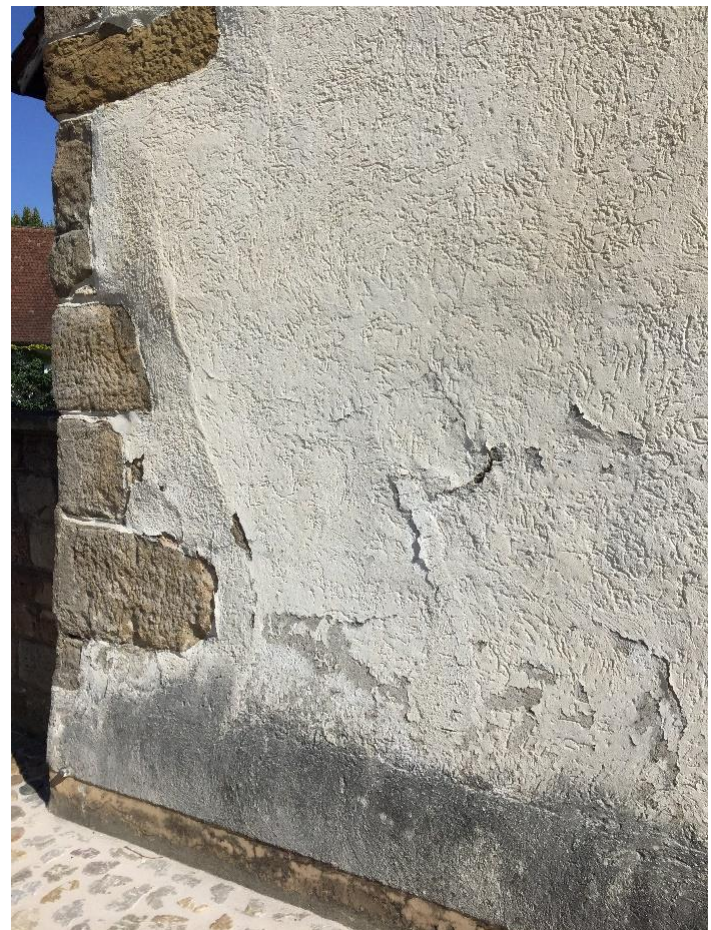
Fassade: Verputz stark beansprucht, teilweise beschädigt
